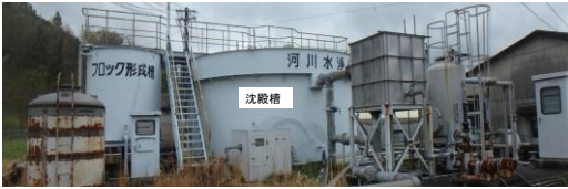
河川水浄化施設
